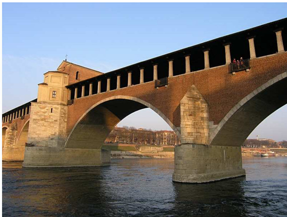
Příloha.9: Valené klenby na mostě přes řeku Ticino v Pavii – Itálie ( http://www.trekearth.com )
